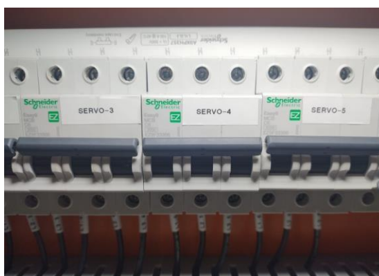
Figura 6 - Disjuntores dos servos
