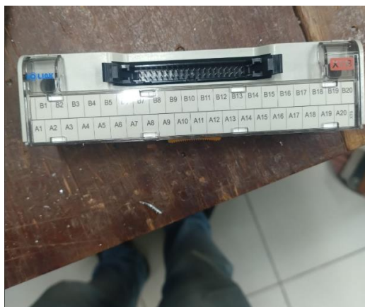
Figura 17 - Módulo de entrada expansor a distância
