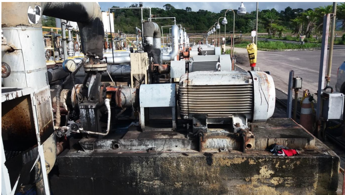
Figura 36 – Bomba centrífuga operando no Parque de Bombas da REMAN (Fonte: Autor)
