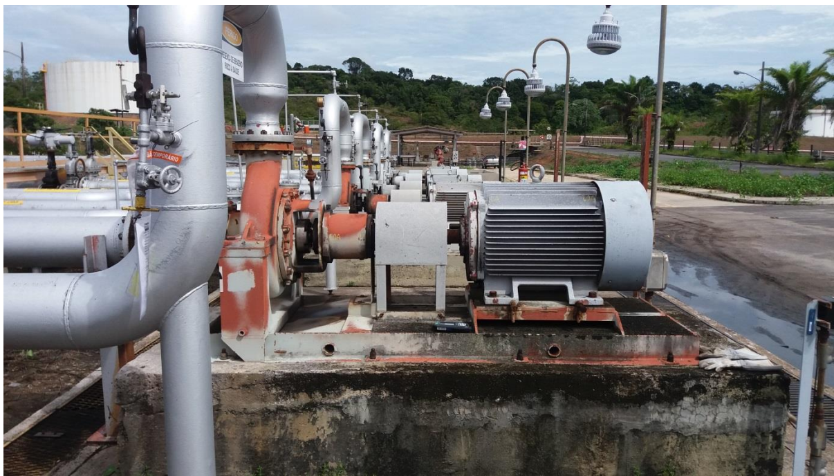
Figura 1 – Bomba Centrífuga operando em parque de bombas na Refinaria de Manaus. (Fonte: Autor).
