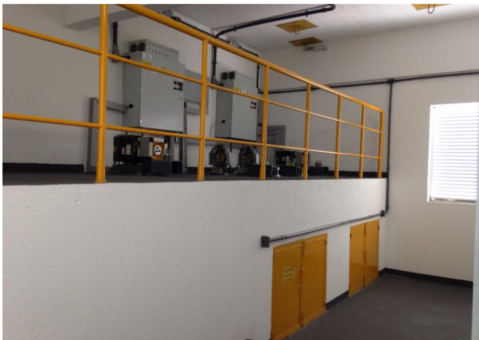
Figura 15- Casa de máquinas de 2 níveis.
