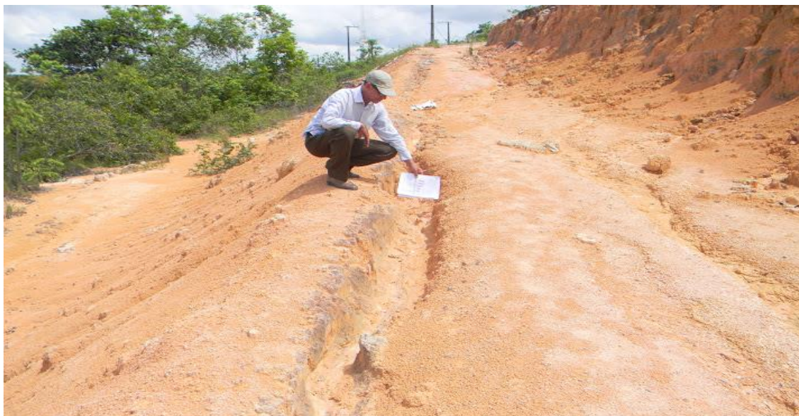
Figura 17 – Erosão tipo sulcos localizada na estrada do bairro de Puraquequara, no Distrito Industrial II.
