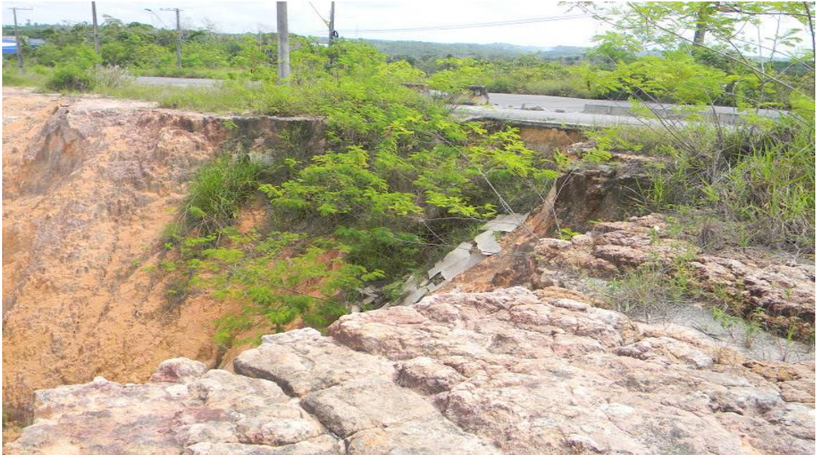
Figura 15 – Erosão tipo voçoroca localizada na estrada do bairro de Puraquequara, no Distrito Industrial II.
