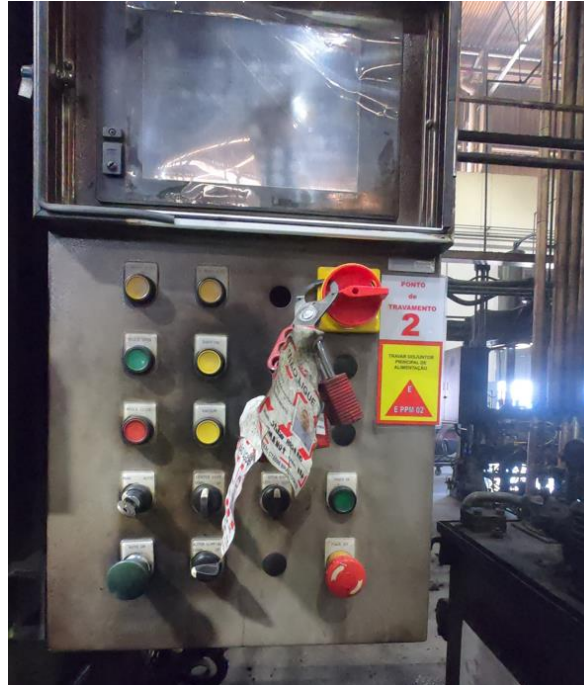
Figura 12 – Ponto de bloqueio elétrico devidamente identificado e bloqueado com chave seccionadora.
