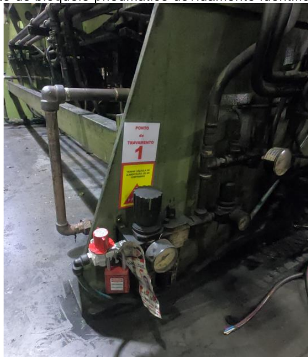
Figura 13 – Ponto de bloqueio pneumático devidamente identificado e bloqueado.
