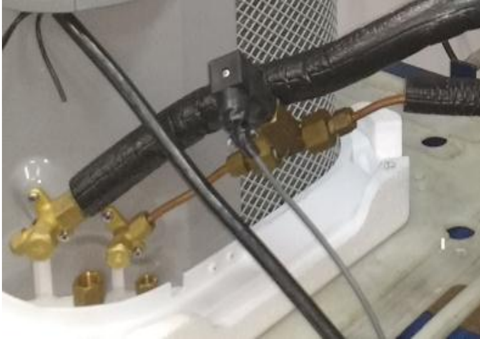
Figura 16 - Tubulações acopladas (unidade interna e externa). Fonte - Autor: mar.2017
