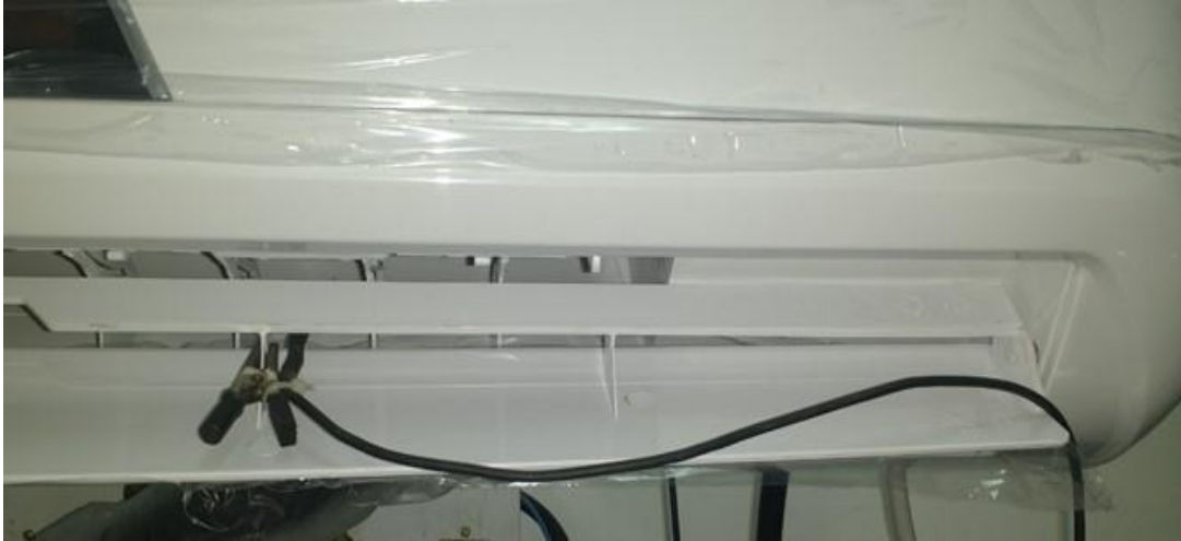
Figura 18 - Sensor de temperatura na saída do evaporador (T1) Fonte - Autor: mar.2017
