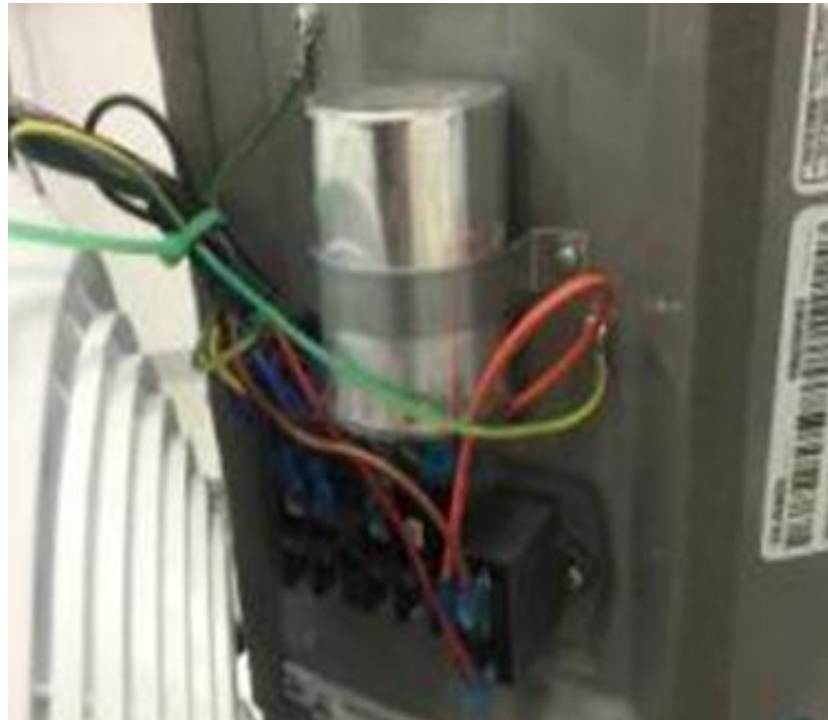
Figura 06 - Inspeção do Capacitor e conexões elétricas. Fonte - Autor: mar.2017
