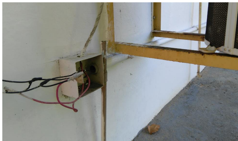
Figura 11: Isolamento elétrico mal executado Fonte: O autor, em 2017.
