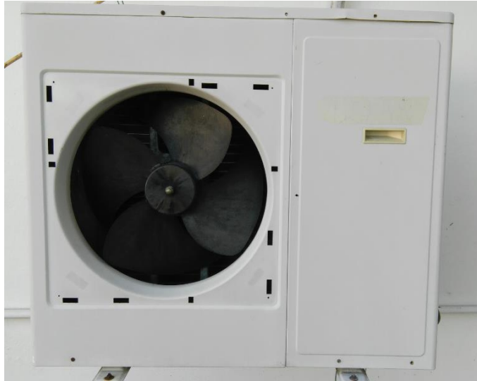
Figura 12: Unidade condensadora sem tela de proteção Fonte: O autor, em 2017.
