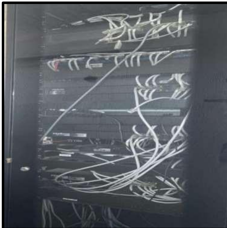
Figura 12 - Equipamentos ligados diretamente no switch: Fonte: Autor
